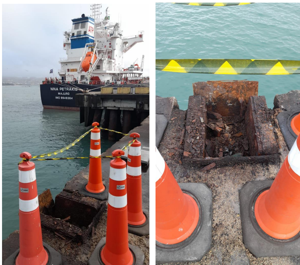
Figura 06 – Detalhes da avaria do cabeço 2, Cais 1 do Porto de Imbituba.
